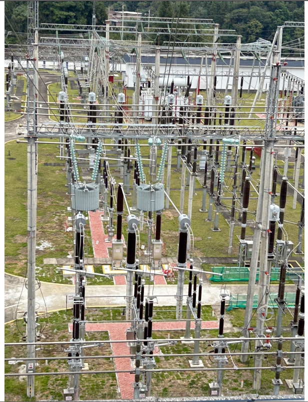
三江变电站内间隔绿化情况图
