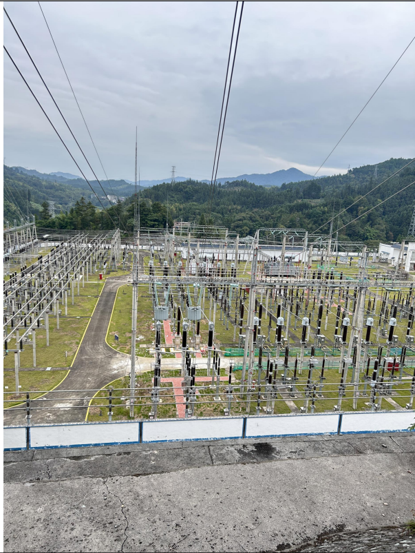
三江变电站内间隔绿化情况图
